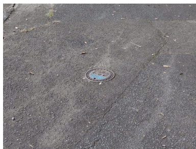
上水道（仕切弁）
