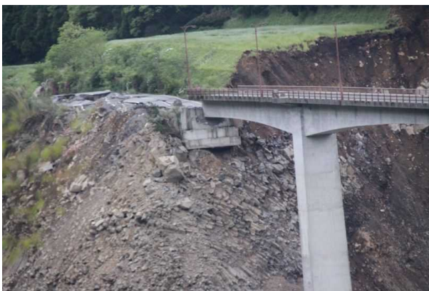
斜面崩壊等により、損傷した橋
