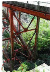
ボルトの破断
