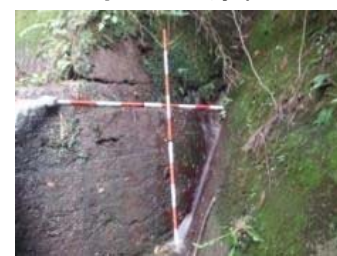
垂直壁袖部のクラック
