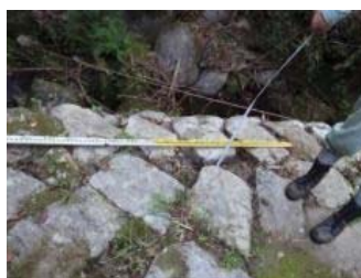
袖天端張石の流出
