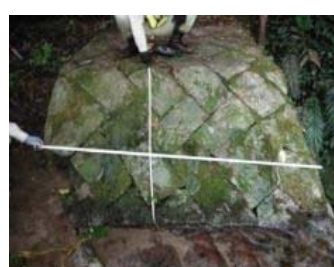
袖小口の断面欠損
