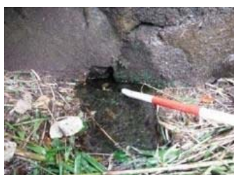
堰堤下流の空洞
