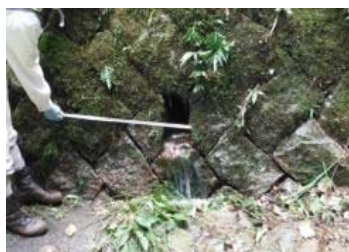
右岸袖部の空洞
