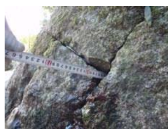
空隙からの漏水
