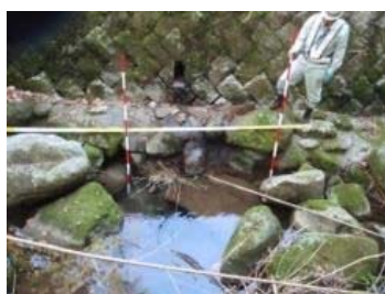
基礎部の漏水
